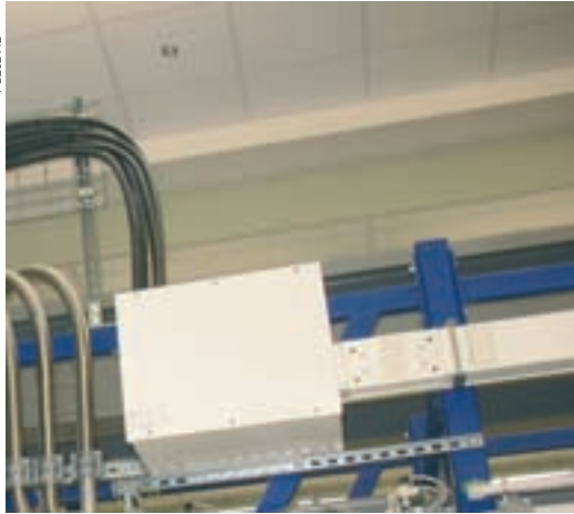
Canalis KS and sprinkler.
